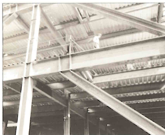
Excentrische portaalverstijvingen in een ziekenhuis in Californië.
