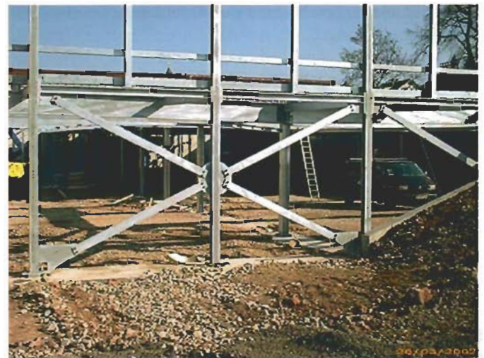
Fig. 1. Car park with X-type bracing after steel assembly Bild 1. Parkdeck mit Kreuzverband im Bauzustand
